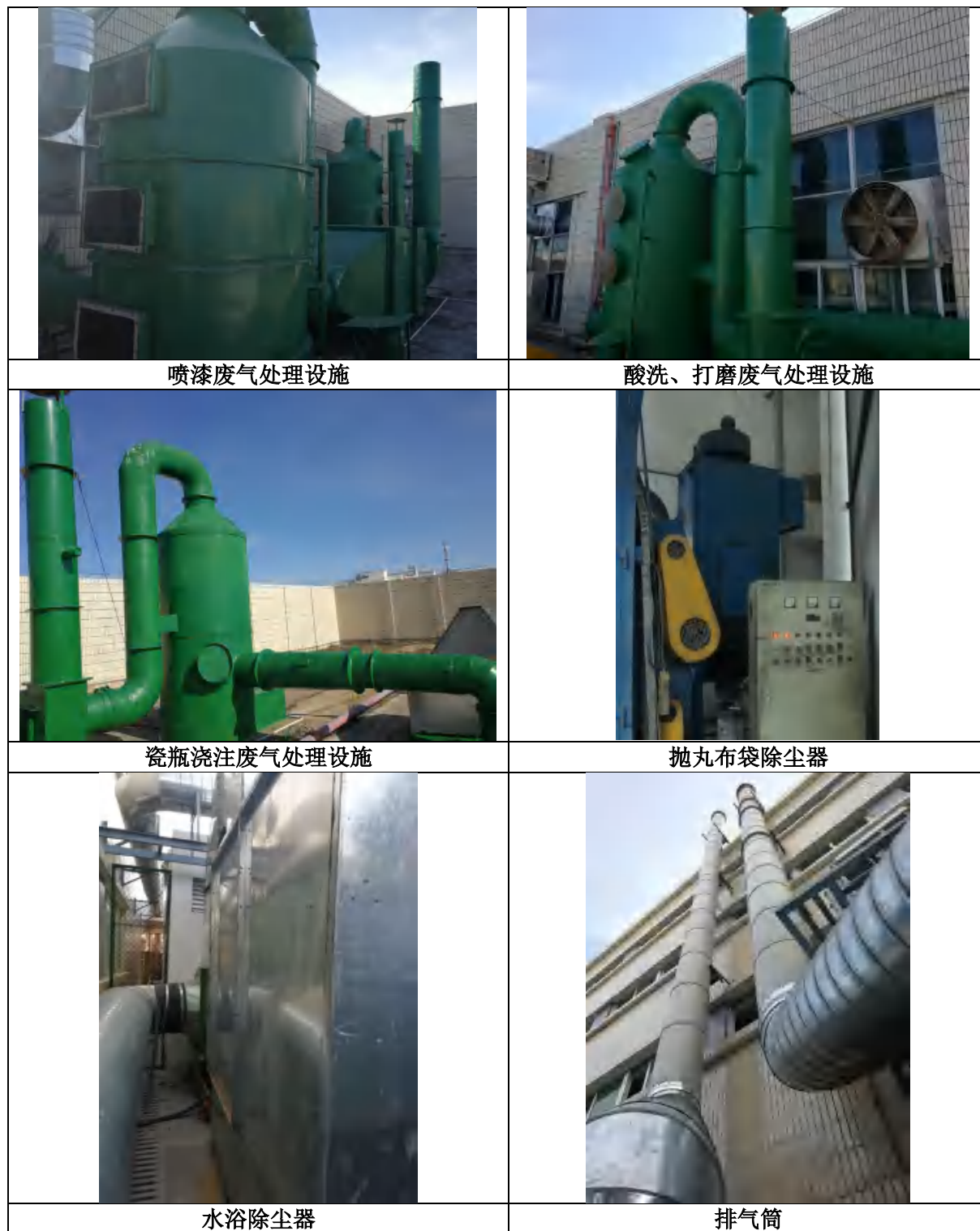
图 3.4.15 废气处理设施相关照片
