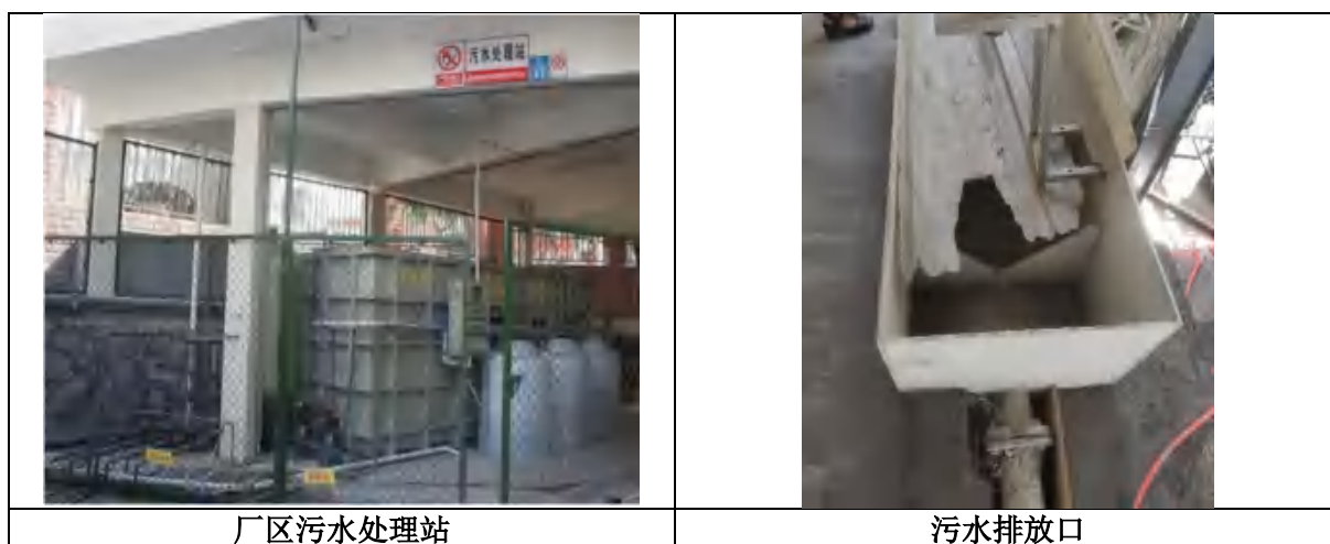
图 3.4.11 废水处理设施相关照片
